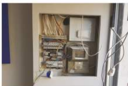
πλήρης ηλεκτρολογική εγκατάσταση νέοι πίνακες & καλωδιώσεις
