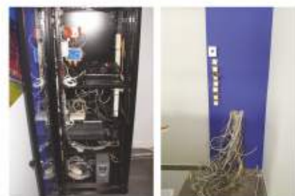
καμίνες RACK για συγκέντρωση και διαχείριση όλου του ηλεκτρολογικού ηλεκτρονικού εξοπλισμού - modulators
